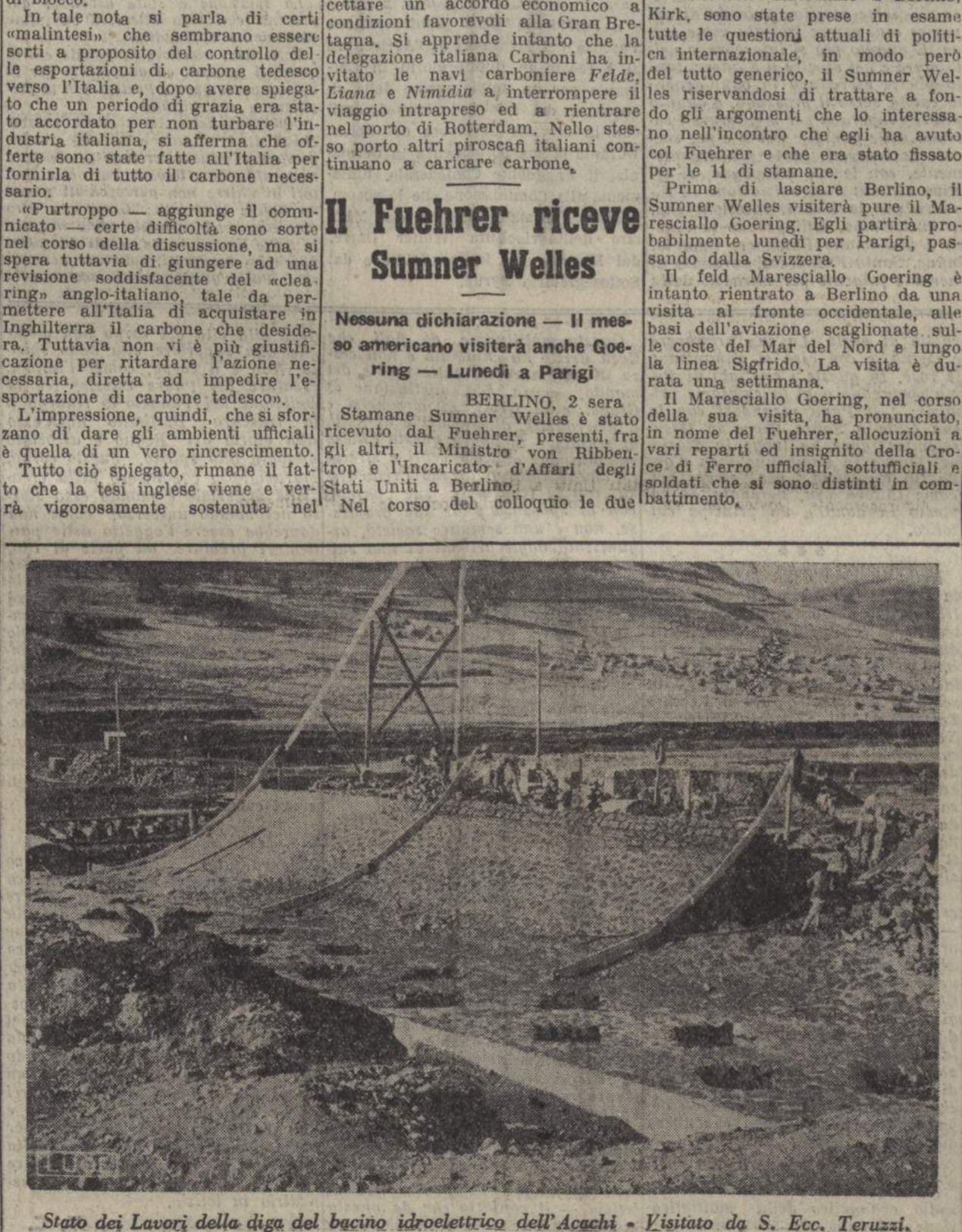
Stato dei Lavori della diga del bacino idroelettrico dell'Acachi - Visitato da S. Ecc. Teruzzi.
